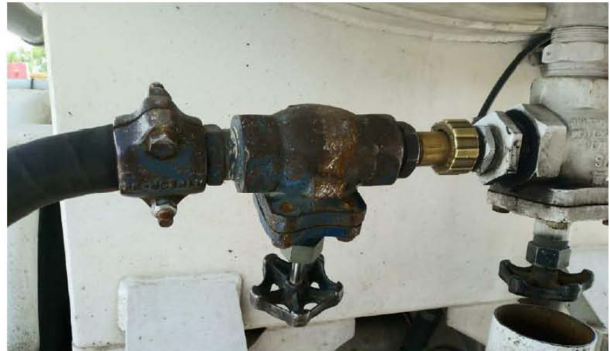
SUMINISTRO DE VAPOR AL SEMIRREMOLQUE
