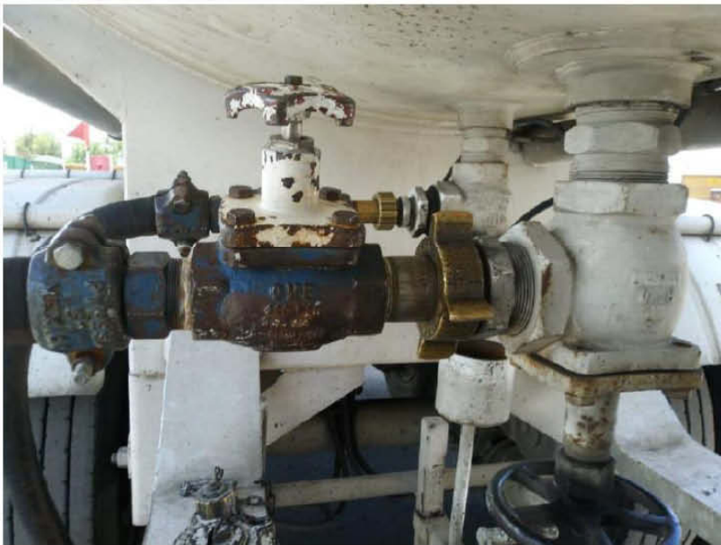
RECEPCION DE GLP DESDE EL SEMIRREMOLQUE
